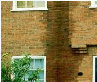
Fig. 3: duidelijk zichtbare vochtproblemen in de gevel
