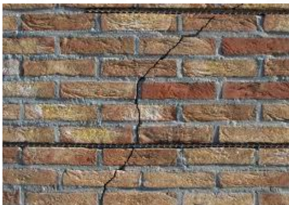
Fig. 5: scheur in de gevel
