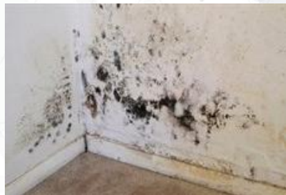
Fig. 4: schimmelvorming in de woning
